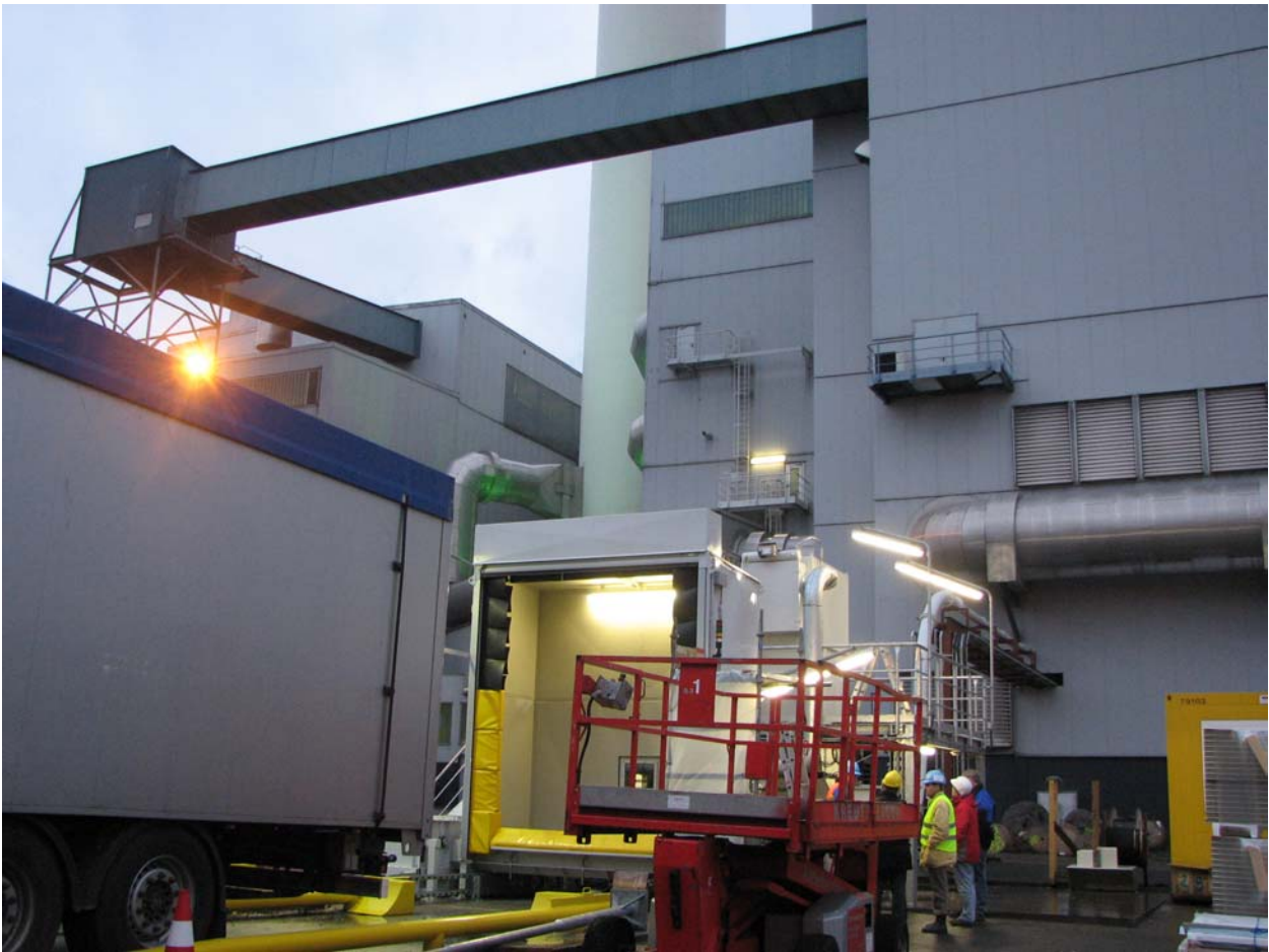
Abbildung 5 Walking-Floor-Entladung und Kompaktannahmestation am Kraftwerk Flensburg
